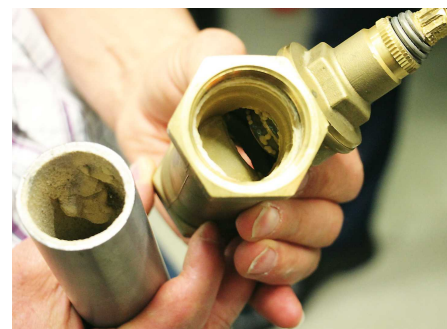
So sahen die Leitungen und ein Schrägsitzventil vor dem Betrieb der Biocat Kalkschutzanlage aus. Bild: Manfred Dittenhofer
