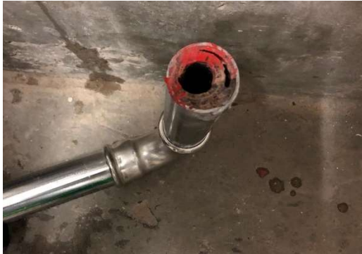
Anschluss Speicherladeleitung nach drei Jahren ohne BIOCAT
