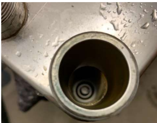
Anschluss Wärmetauscher nach drei Jahren mit BIOCAT
